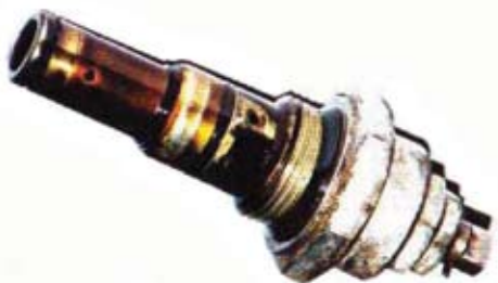
Fot. 2. Produkty utleniania oleju powlekające zawór regulacji ciśnienia
